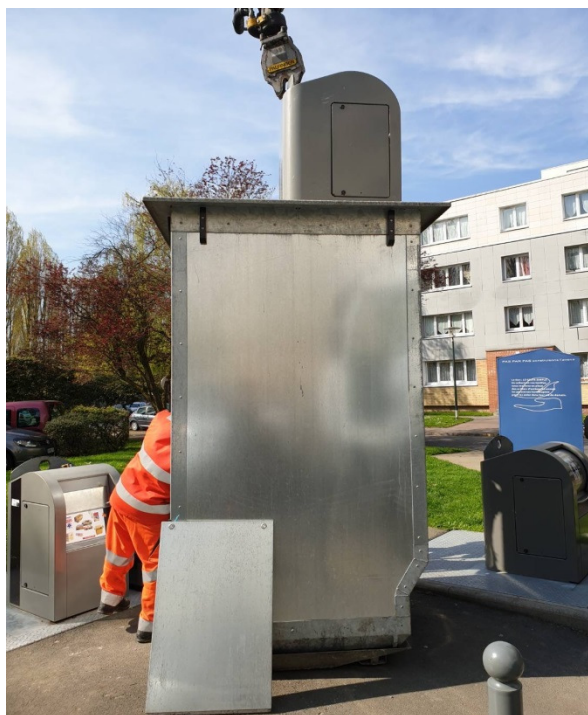
Monterat på UnderJordSystem
